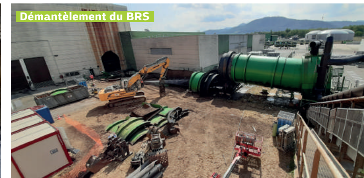
L'installation après l'incendie
